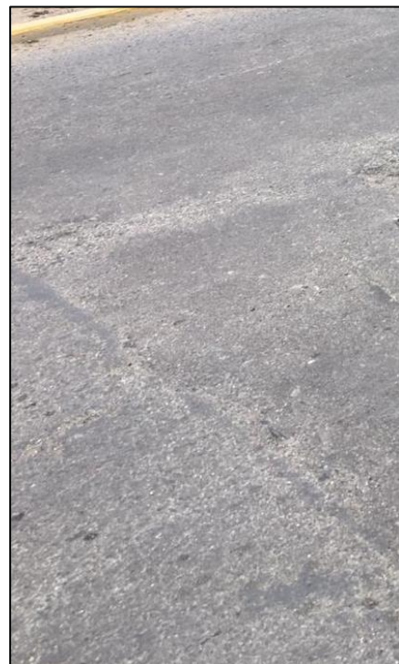
Figura 70. Falla de tipo parcheo de severidad baja.
