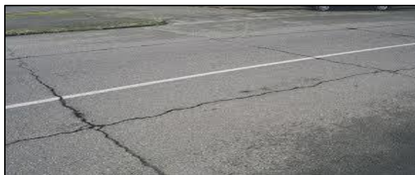
Figura 9. Grieta de reflexión
