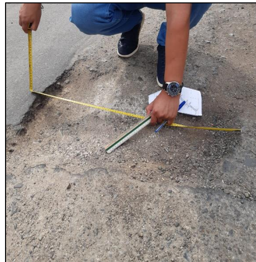
Figura 49. Falla de tipo parcheo de severidad media.
