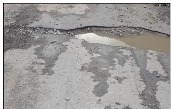
Figura 62. Falla de tipo huecos de severidad media.
