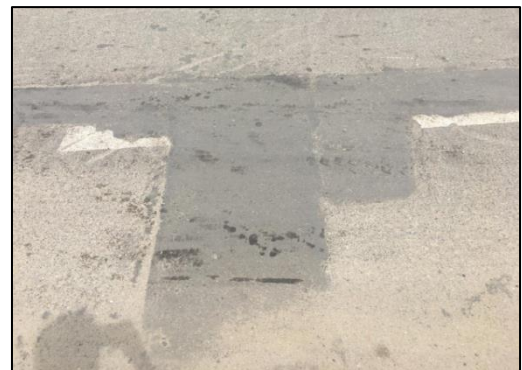
Fig.33. Falla de tipo parcheo de severidad media.
