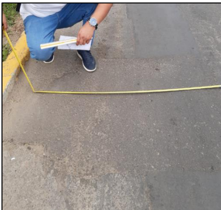
Figura 45. Falla de tipo parcheo de severidad media.
