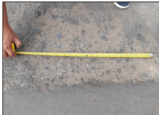
Figura 43. Falla de tipo desprendimiento de agregados de severidad alta y falla de tipo hueco de severidad media.
