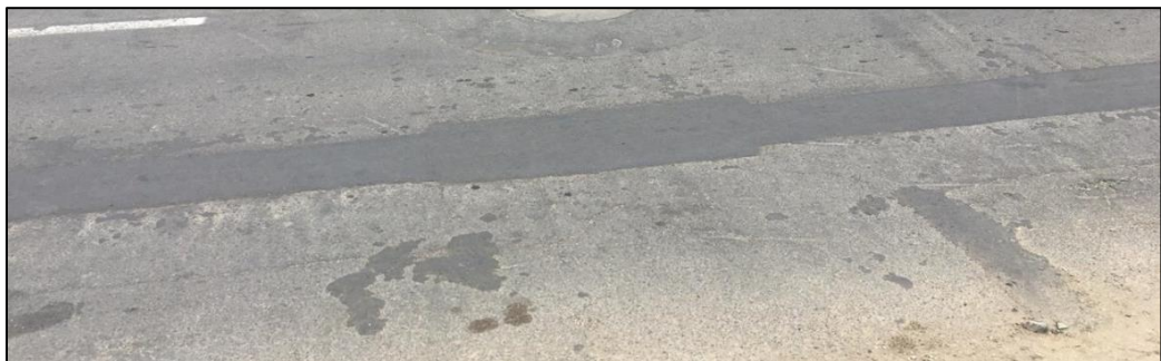
Figura 50. Falla de tipo parcheo de severidad media.
