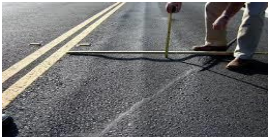
Figura 19. Meteorización y desprendimiento de agregados
