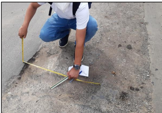
Figura 36. Falla de tipo hueco de severidad alta.
