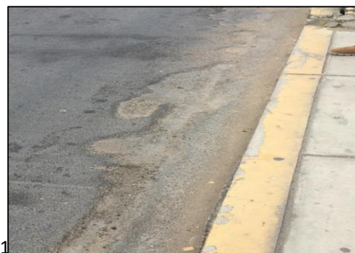
Fig. 35. Falla de tipo huecos de severidad media.
