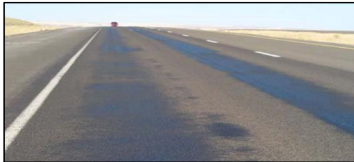
Figura 2. Exudación en pavimentos
