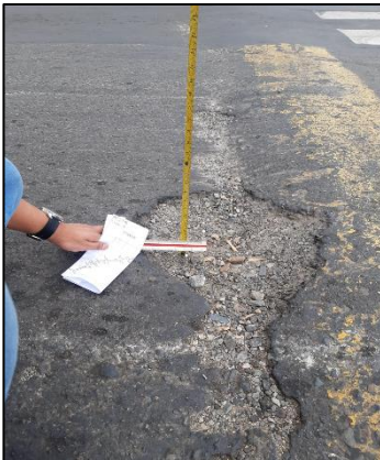
Figura 90. Falla de tipo hueco de severidad media.
