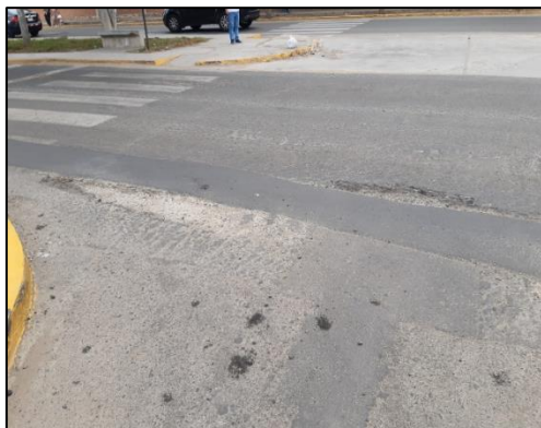
Figura 53. Falla de tipo parcheo de severidad media.
