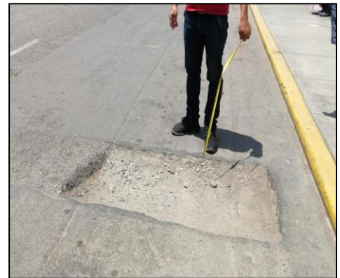
Figura 64. Falla de tipo huecos de severidad alta.
