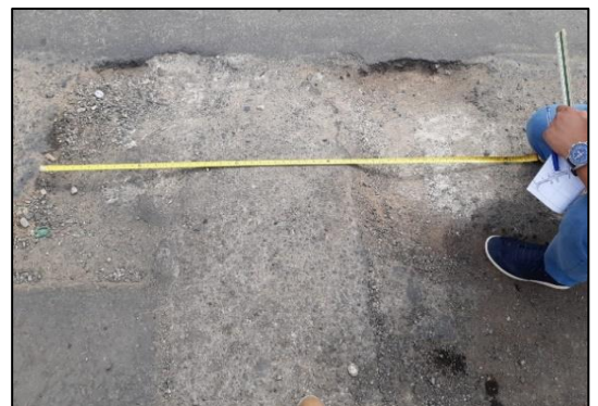
Figura 37. Falla de tipo pulimientos de agregados de severidad alta.
