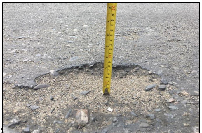
Figura 59. Falla de tipo huecos de severidad media.
