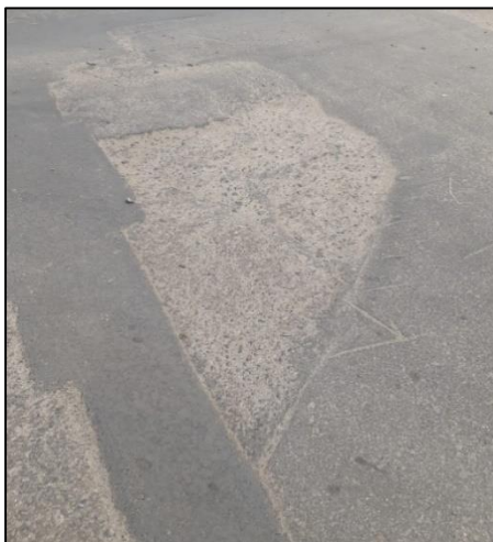
Figura 39. Falla de tipo piel de cocodrilo de severidad alta.
