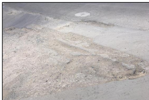
Figura 55. Falla de tipo desprendimiento de agregados de severidad media. 95
