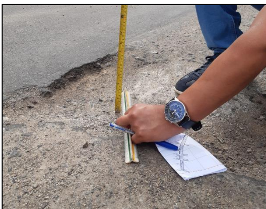
Figura 38. Falla de tipo pulimientos de agregados de severidad alta.
