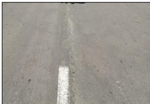
Figura 101. Falla de tipo desprendimiento de agregados de severidad media.
