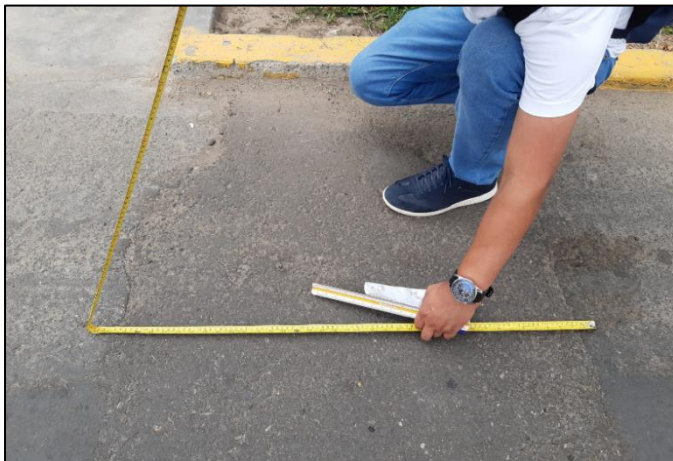
Figura 58. Falla de tipo parcheo de severidad media.
