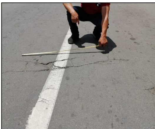
Figura 60. Falla de tipo grietas longitudinal y transv. de severidad media.
