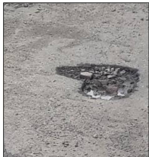
Figura 52. Falla de tipo hueco de severidad media.
