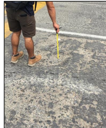
Figura 91. Falla de tipo grieta de borde de severidad media.
