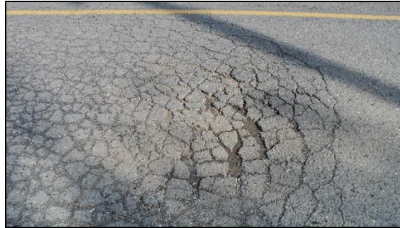
Figura 1. Piel de cocodrilo en pavimentos flexibles
