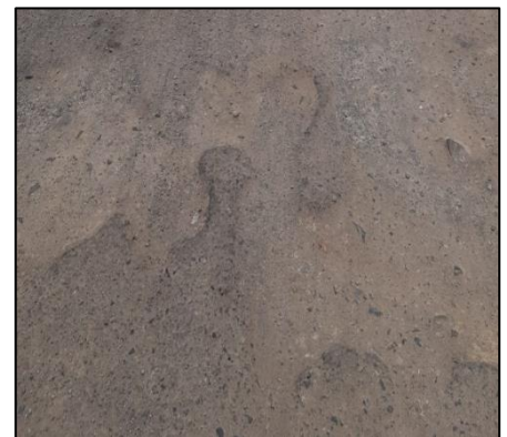
Figura 54. Falla de tipo huecos de severidad media.
