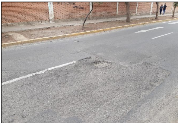
Figura 69. Falla de tipo pulimiento de agregados de severidad media.
