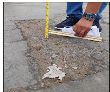
Figura 87. Falla de tipo piel de cocodrilo de severidad media.
