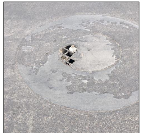
Figura 47. Falla de tipo huecos de severidad alta.
