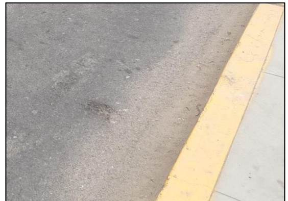
Figura 72. Falla de tipo pulimento de agregados de severidad baja.
