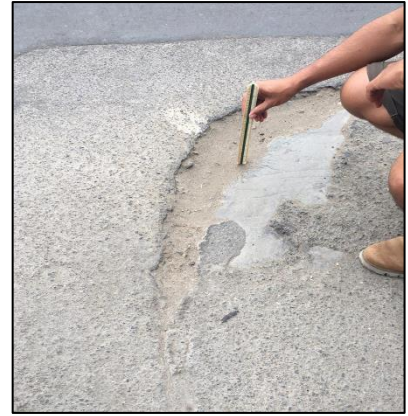
Figura 89. Falla de tipo hueco de severidad media.
