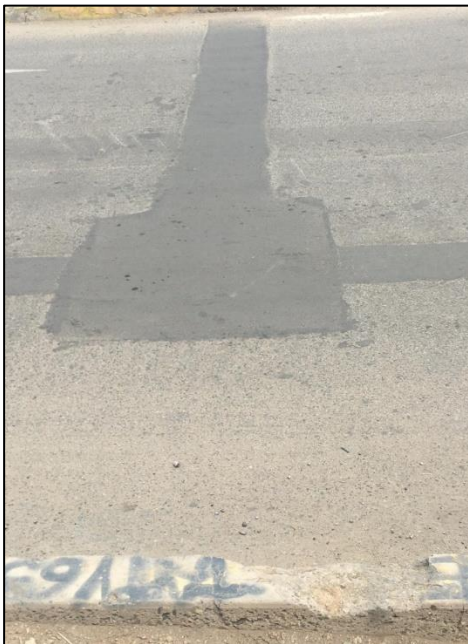
Figura 48. Falla de tipo desprendimiento de agregados de severidad media.
