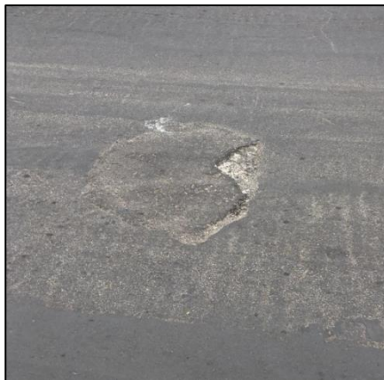
Figura 46. Falla de tipo desprendimiento de agregados de severidad media.
