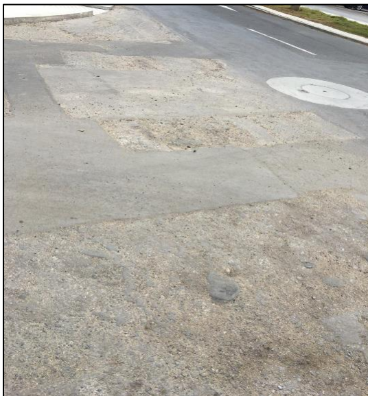
Figura 80. Falla de tipo grieta de borde de severidad media.
