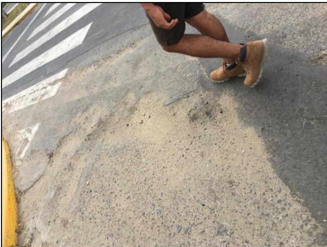
Figura 82. Falla de tipo pulimiento de agregados de severidad media.
