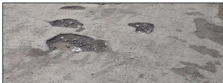
Figura 65. Falla de tipo huecos de severidad media.
