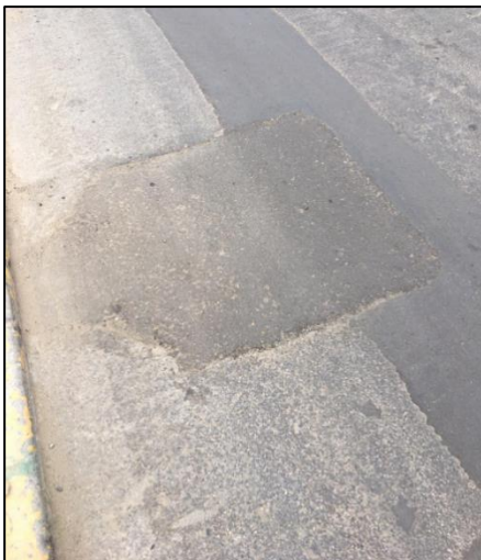
Figura 51. Falla de tipo parcheo de severidad media.
