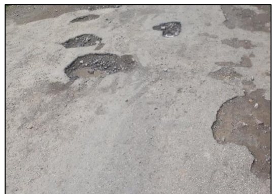
Figura 61. Falla de tipo huecos de severidad alta.
