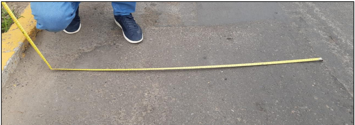
Figura 56. Falla de tipo parcheo de severidad media.
