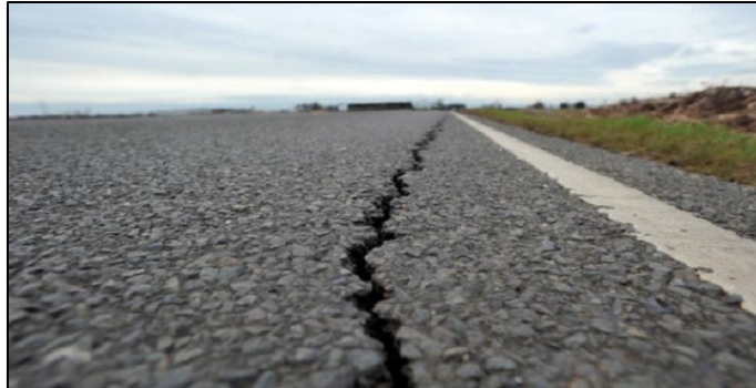
Figura 8. Grieta de borde
