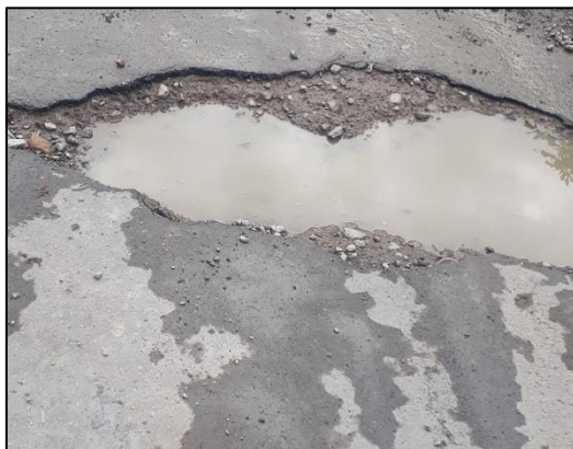
Figura 99. Falla de tipo hueco de severidad alta.
