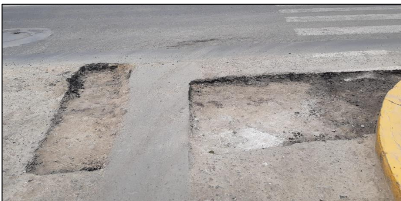
Figura 57. Falla de tipo huecos de severidad media.
