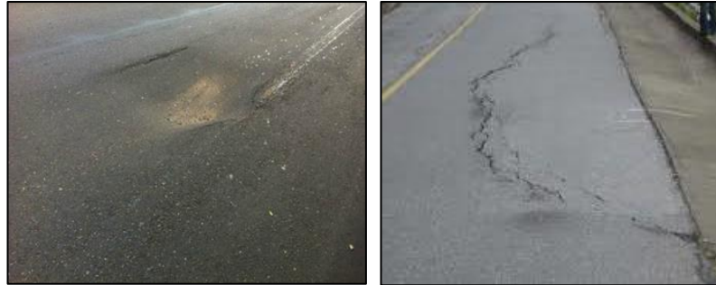
Figura 5. Hundimientos y abultamientos en pavimentos flexibles
