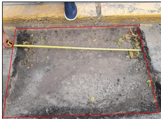
Figura 68. Falla de tipo parcheo de severidad media.
