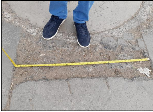
Figura 88. Falla de tipo grieta de borde de severidad media.
