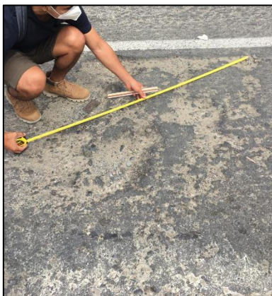
Figura 92. Falla de tipo grieta de borde de severidad media.
