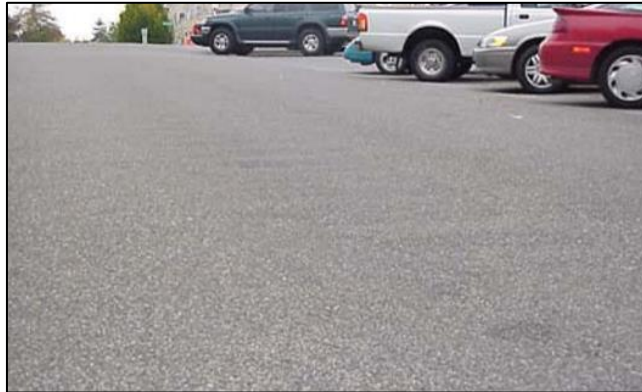
Figura 6. Corrugaciones en pavimentos flexibles
