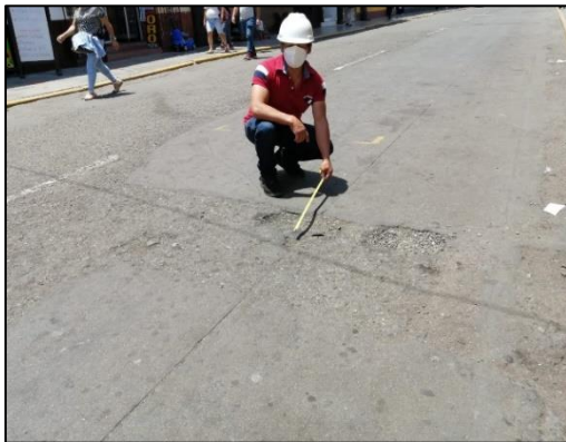
Figura 63. Falla de tipo desprendimiento de agregados de severidad media.
