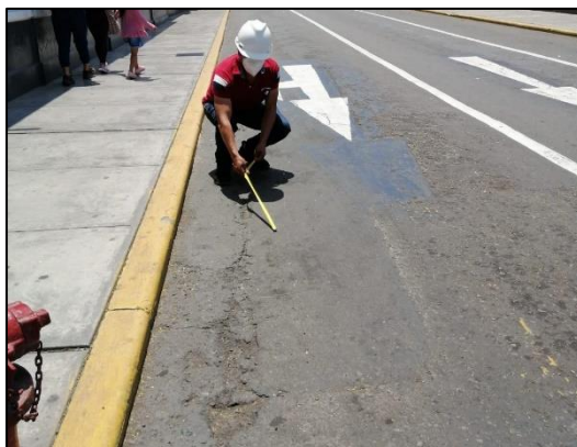
Figura 100. Falla de tipo desprendimiento de agregados de severidad media.
