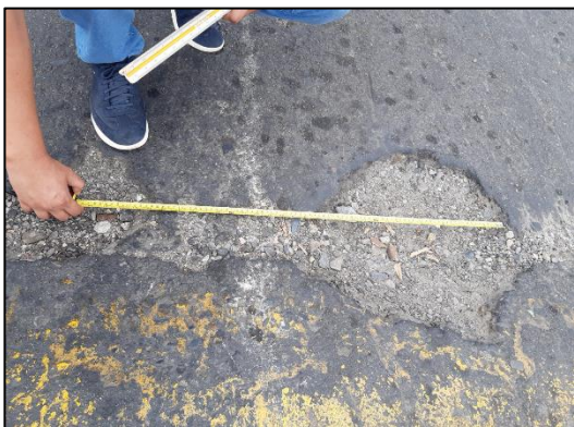
Figura 86. Falla de tipo huecos de severidad media y falla de tipo pulimiento de agregados de severidad alta
