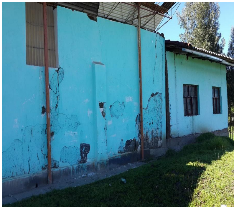
IMAGEN N° 12: Año 1970: Daños Ocasiones por Sismo
