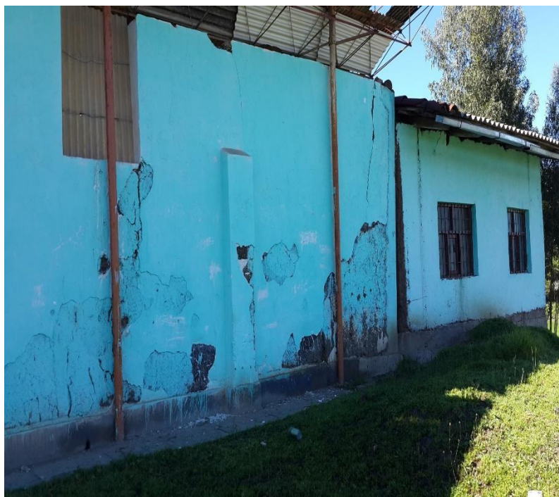
IMAGEN N° 12: Año 1970: Daños Ocasionados por Sismo
