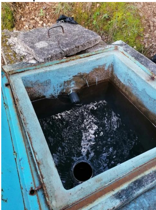
Imagen 11. Cámara Rompe Presión Tipo 6 - Sarin
