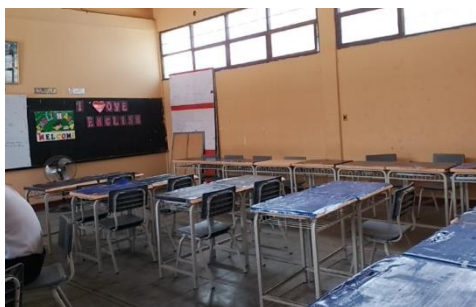
IMAGEN N°34: ESTADO ACTUAL DE AULAS DEL NIVEL SECUNDARIO FUENTE: VISITA DE CAMPO
