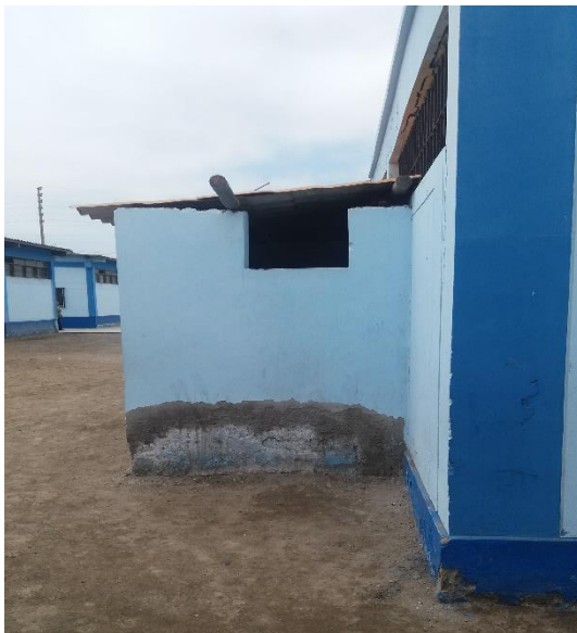
IMAGEN N°30: ESTADO ACTUAL DE COBERTURAS FUENTE: VISITA DE CAMPO
