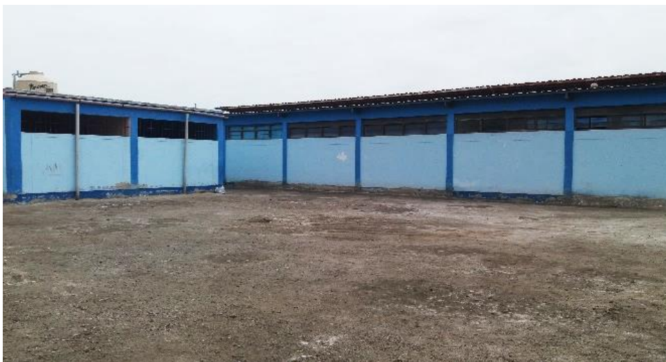
IMAGEN N°29: ESTADO ACTUAL DE MUROS Y PAVIMENTOS FUENTE: VISITA DE CAMPO
