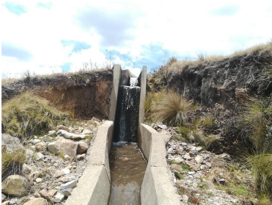
Fotografía 08 : Vista de estructuras deficientes en el tramo del canal Uchucubamba. Fuente: Propia
