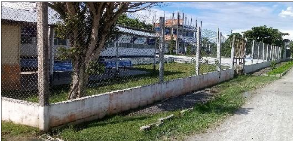
Figura 12. El cerco perimétrico tiene muros de albañilería y también con una cerca metálica insegura y deficiente, lo cual no muestra unidad con el entorno.
