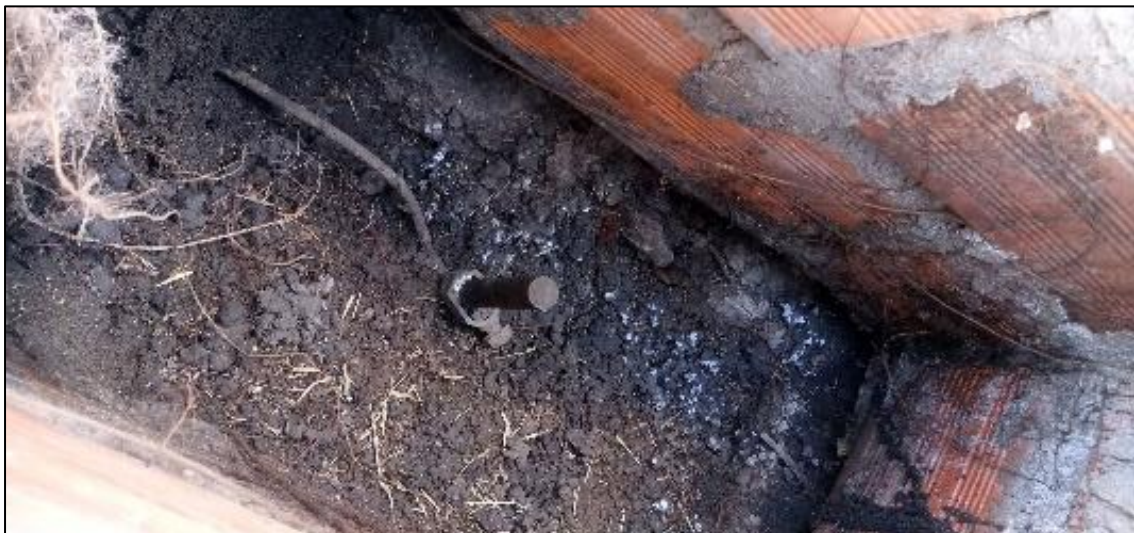
Figura 14. Caja de registros de desagüe en la cual hay un pozo a tierra (barra de cobre), mal señalado.
