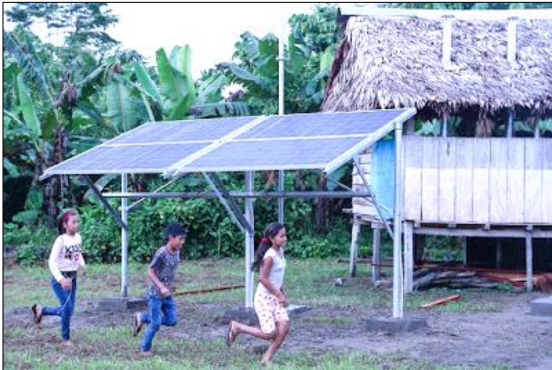
Figura 26. Panel fotovoltaico ubicado en una escuela de la selva.
