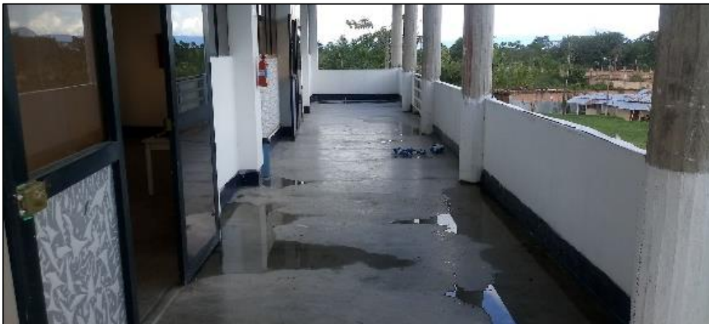
Figura 11. Bloque Edificación II, cerca del ingreso, tiene problemas en la cubierta y el agua de lluvias se empoza en el pasillo del segundo nivel
