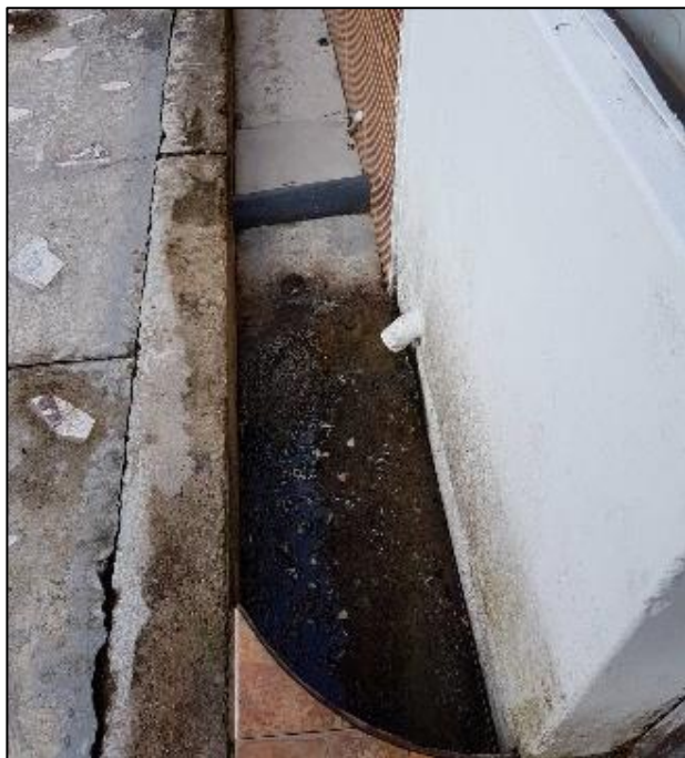
Figura 16. Inadecuado sistema de canaletas, por lo que se empoza el agua de lluvia en niveles bajos.
