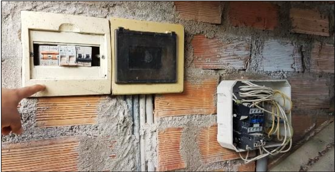
Figura 13. Instalaciones eléctricas y tuberías expuestas.
