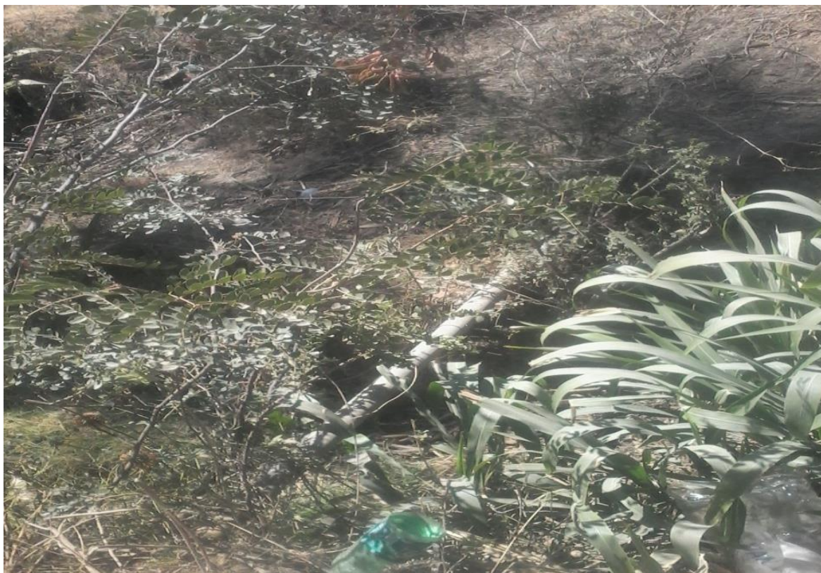
Foto 05. Tubería expuesta y deteriorada
