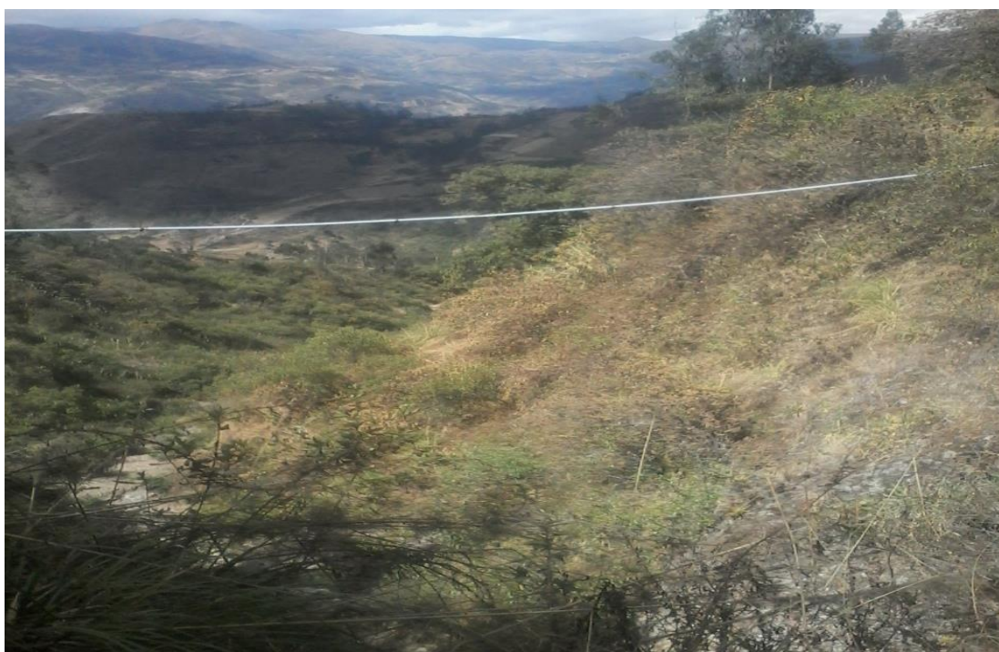
Foto 04. Pase aéreo existente en mal estado
