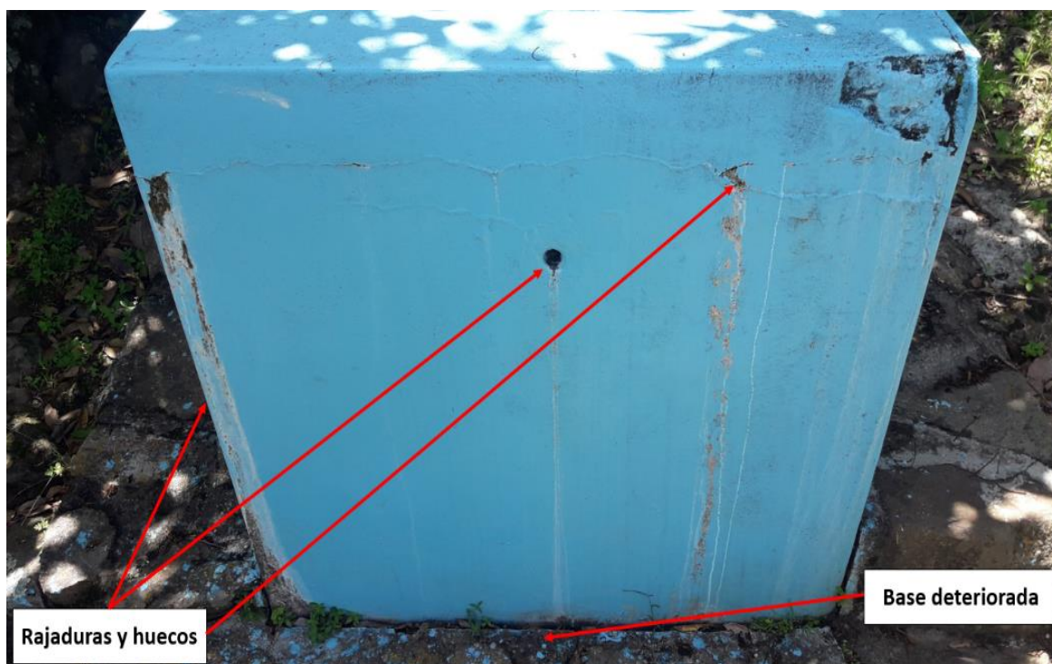
Foto 06. Cámara rompe presión existente en mal estado
