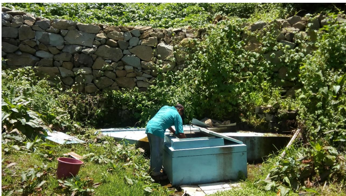
Foto 03. Captación en mal estado
