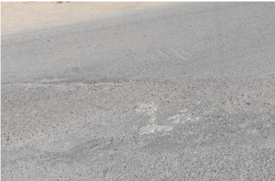
Fallas Superficiales en Carretera Macabi Alto
