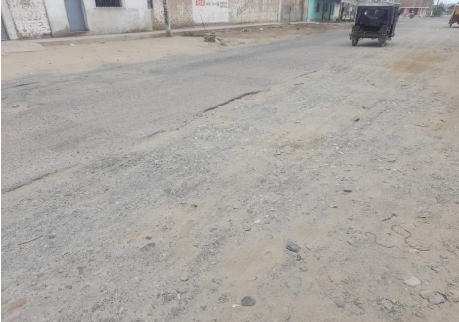
Fallas Superficiales en Carretera de Paiján
