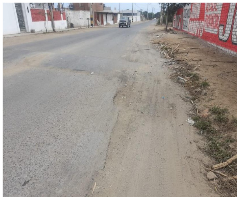
Grieta de Borde
