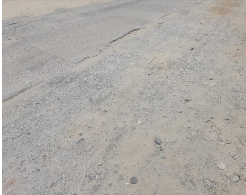
Desprendimiento de Carpeta Asfáltica
